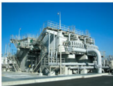
Open Rack type LNG Vaporizers
